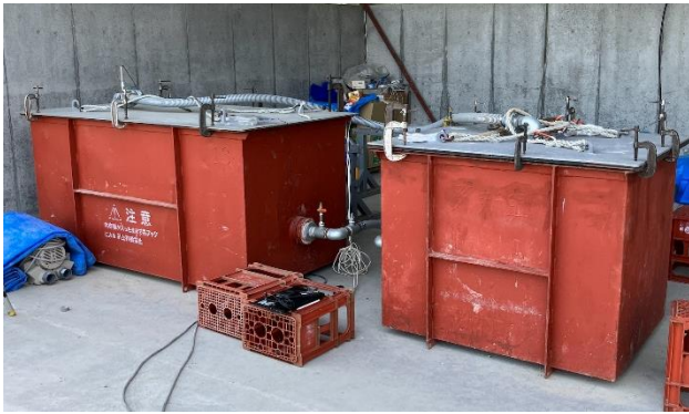
写真1 CO 2 固定化仮設備
